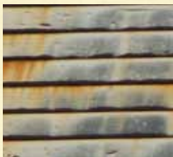
錆びた金属屋根
